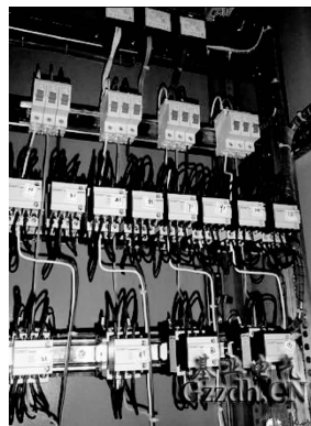
图 1-4 低压电气控制柜
